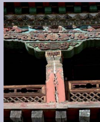
Pilier de balustrade déformé par le tremblement de terre de 1905
